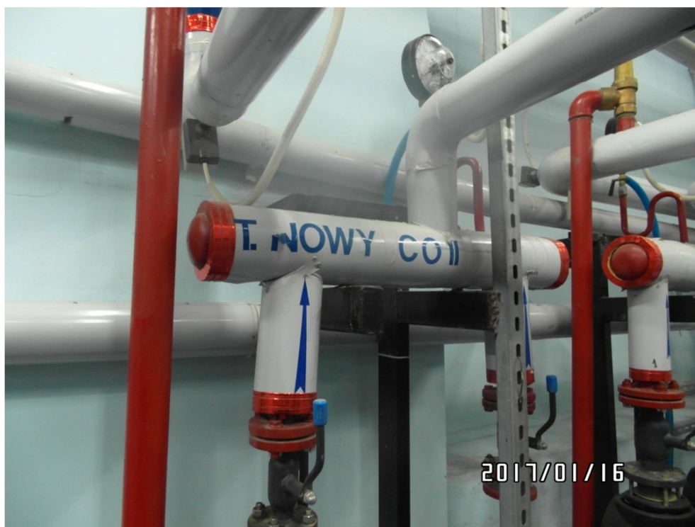
Węzeł cieplny [ budynek Dużej sceny }
